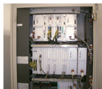
監視端末内部
