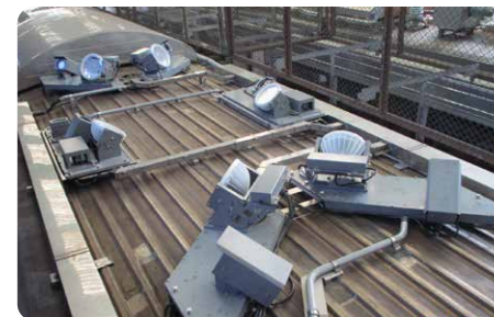
九州旅客鉄道株式会社に納入した電車線路モニタリング装置
